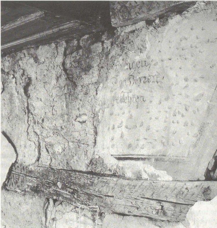
Abb. 13 Gefach der Renaissancezeit, Aufnahme 1997. Der nachträglich aufgetragene Mörtel ist abgeblättert, darunter kommen die Hackspuren auf der bauzeitlichen Mal- und Füllungsschicht zum Vorschein (LDA, A. W.).
