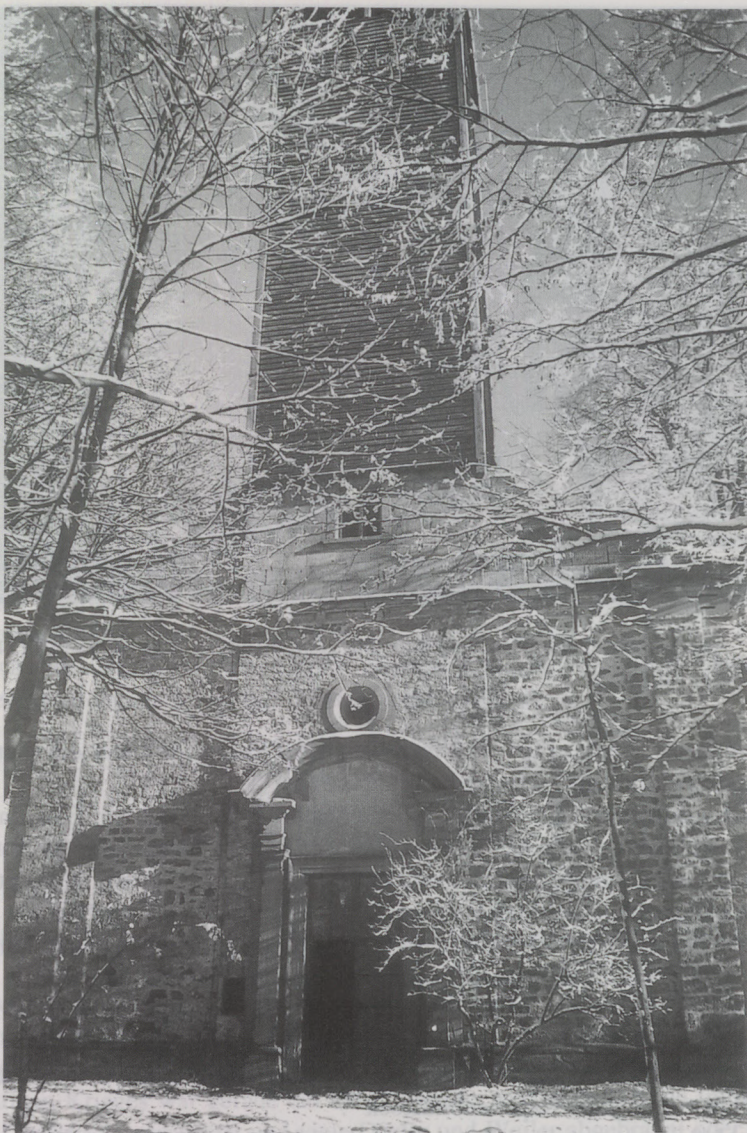
Abb. 6 Die Fassade der Kirchenruine auf dem Einkorn von Westen (Zustand 1998), Foto: Verfasser.
