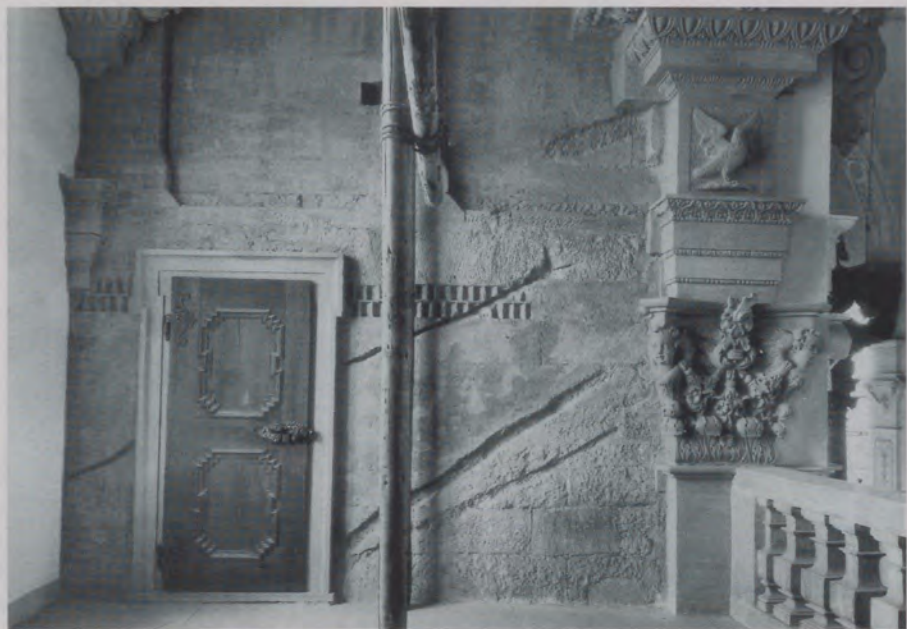
Abb. 13 Dachanschläge. An der Westwand des Nordturmes ist deutlich die unterschiedliche Neigung und Höhe des wiederholt veränderten Mittelschiffdaches ablesbar.
