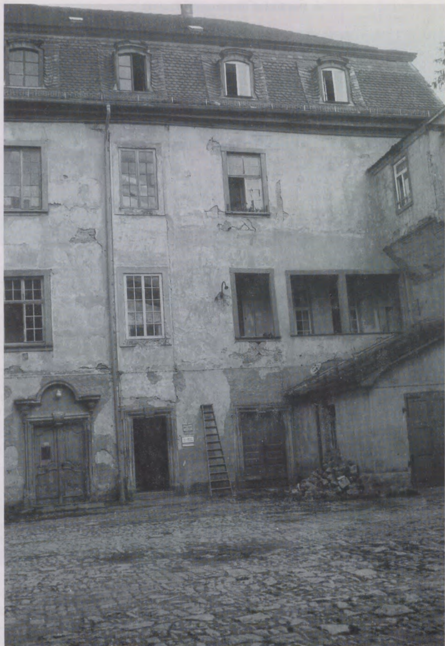
Abb. 20 Schloß Pfedelbach, Südflügel, Hofseite. Durch die begonnene Barockisierung ist der Treppenturm in der Fläche des vorgelegten Ganges und unter dem Mansarddach verschwunden. Hinter den Fenstern sind die Läufe der Wendeltreppe zu sehen. Die Loggia und die Vorbauten sind 19. und 20. Jahrhundert. Aufn. W.-G. Fleck 1962
