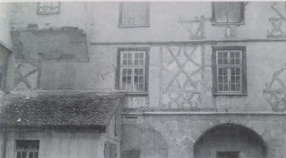
Abb. 21 Schloss Pfedelbach, Westgalerie, Hofseite 1966. Das von der barocken Veränderung unberührt gebliebene Renaissancefachwerk ist teilweise freigelegt. Aufn. W.-G. Fleck
