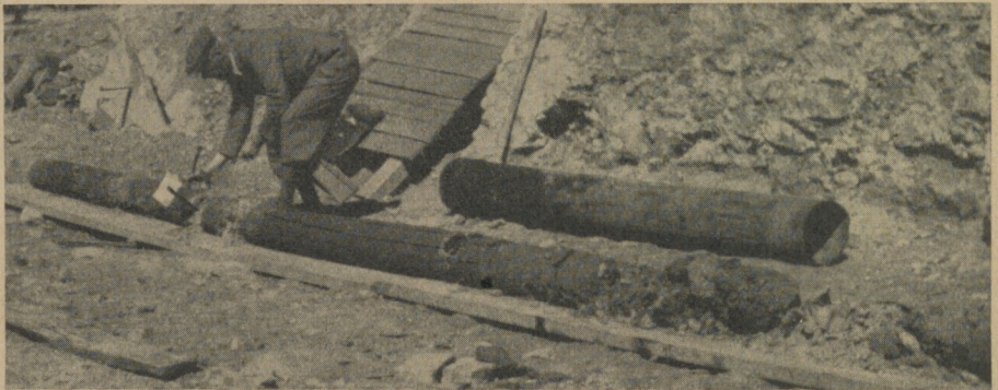
Abb. 25. Ein Bohrkern aus dem Baugrund der Landeszentralbank Schwäbisch Hall, im Hintergrund eine Bohrhütte aus Stahl. Am linken Bildrand der obere Teil des Bohrkerns, im Kellerboden von 4 m Tiefe beginnend, mit mittelalterlicher, schwarzer Brand- und Siedlungsschicht. An den weißen eingesteckten Täfelchen in dunklerer Färbung erkennbar die Keltenschichten. Vom Berichterstatter nach rechts sich 2\frac{1}{2} m lang erstreckend die nach der Tiefe folgende Aulehmschicht unter der Keltensiedlung, unter dieser (nach rechts gelegt) die Geröllschichten der Aufschotterungen des eiszeitlichen, von Bodenschichten heute überlagerten Kocherlaufes (siehe WFr NF 20/21, S. 44, Abb. 4). (Aufnahme: C. Wagner)
