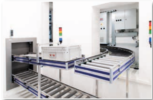
Abb. 4: Sende- und Empfangsstation mit Ausschleuse-Bahn im Erdgeschoss
