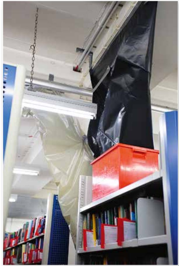
Abb. 1: Wassereintrich am 7./8.11.2016, 1. UG, Abschnitt 7
