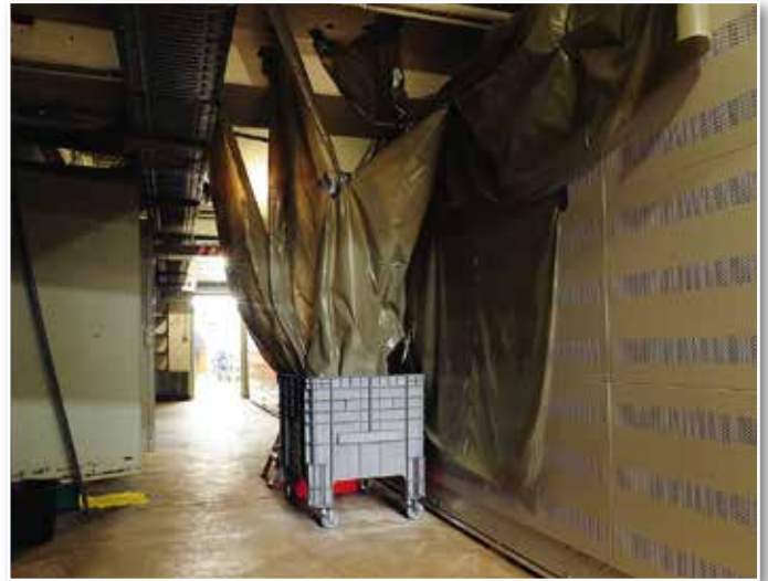
Abb. 3: Wassereinbruch am 23.12.2016, 1. UG, Abschnitt 3
