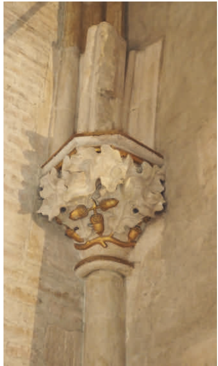
Abb. 6: An der westlichen Chorwand haben sich die Reste der ersten Gewölbeplanung erhalten (Foto: Anne-Christine Brehm).
