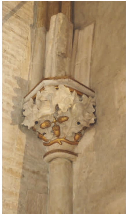
Abb. 6: An der westlichen Chorwand haben sich die Reste der ersten Gewölbeplanung erhalten (Foto: Anne-Christine Brehm).
