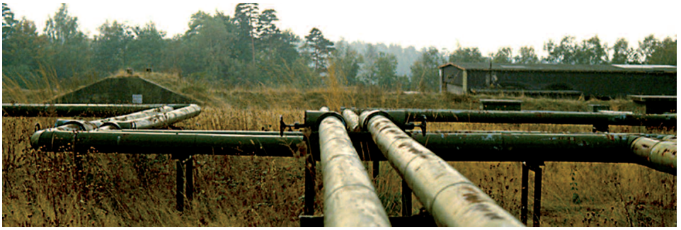
Auf dem herbstlichen Bild von 1985 sind ein Crew-Bunker und eine ehemalige Raketenhalle im Hintergrund zu sehen. Wie auf allen Nike-Abschussflächen waren die Heizungsleitungen oberirdisch geführt und waren bis zum Abbruch erhalten geblieben: (Bild: Thomas Faber, Archiv Thomas Schulz)
