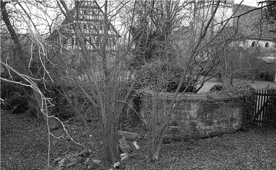
Sanierungsbedürftige Fleckenmauer Ecke Pfarrgarten (Foto W. Stuber, Jan. 2007)
