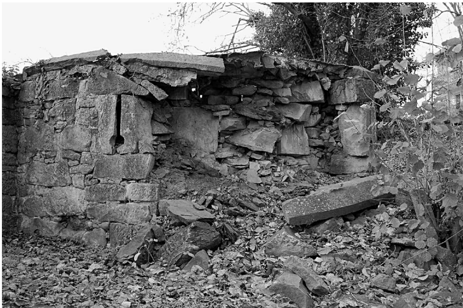
Die Aufnahme vom November 2007 dokumentiert schwere Beschädigungen im Eckturbereich beim Pfarrgarten (Foto W. Stuber)
