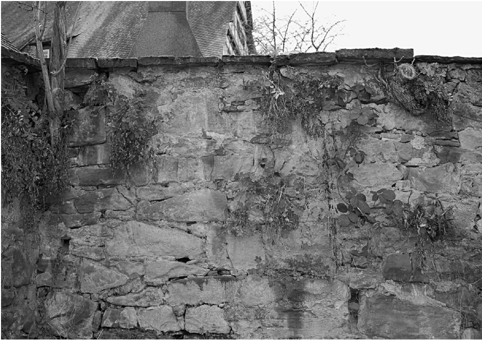
Pflanzen und Sträucher setzten im Laufe der Zeit der Mauer immer wieder zu und machten eine ständige Unterhaltung der Mauer notwendig (Foto W. Stuber, Nov. 2007)
