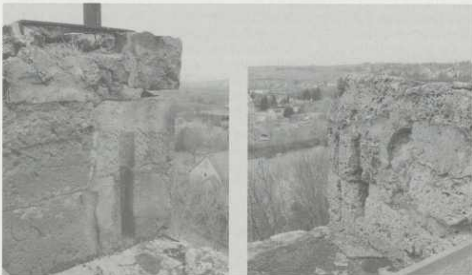
Turmzinnen mit nachträglich eingearbeiteten Prellholznuten.
