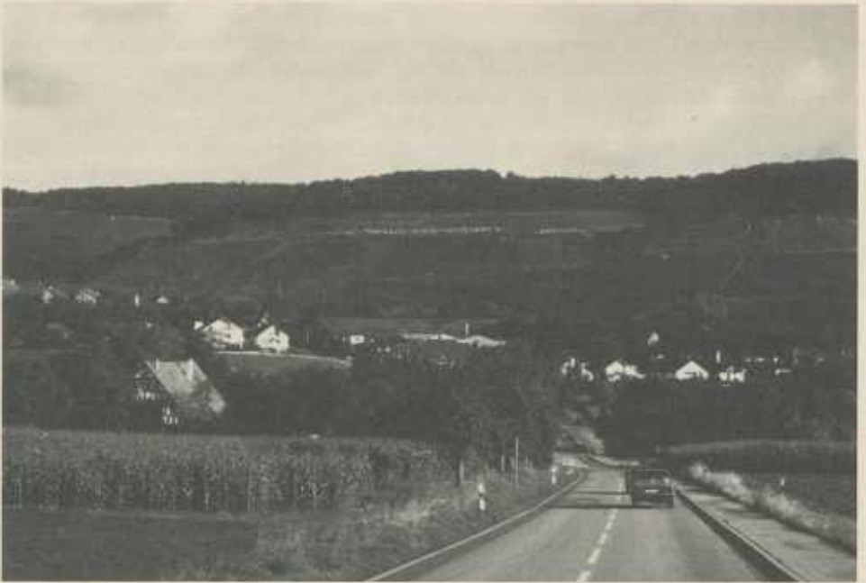
Blick von Süden auf den Rebflurbereinigungshang oberhalb von Spielberg. Die Erd- und Planierungsarbeiten sind in vollem Gange. Den Felskranz im Oberhang bilden die Sandsteinbänke des 1. Stubensandsteinhorizontes (Aufnahme: September 1987)
