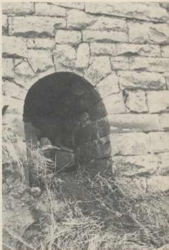
Eingang eines Mergelstollens mit eingebrochenem Gang
