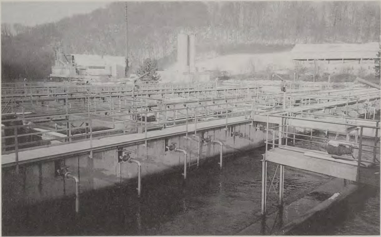
Die umgebauten Kattoxbecken in Belebungsbecken wurden 1990 in Betrieb genommen.
