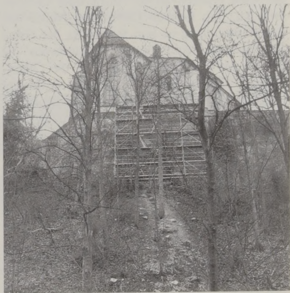
Ein Teil der Stiftskirchenmauer stürzte nach dem Orkan Lothar den Hang hinunter.
