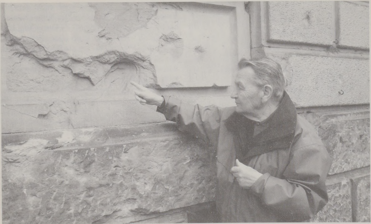
Autor Heinz Rauscher zeigt auf heute noch vorhandene Spuren des Zweiten Weltkriegs am Volksschulgebäude.
