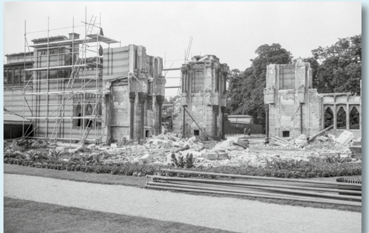
Der Abriss des kriegsbeschädigten maurischen Festsaals in der Wilhelma sorgte für zahlreiche Proteste, 1962 (HStAS Q 2/50 Nr. 1618)
