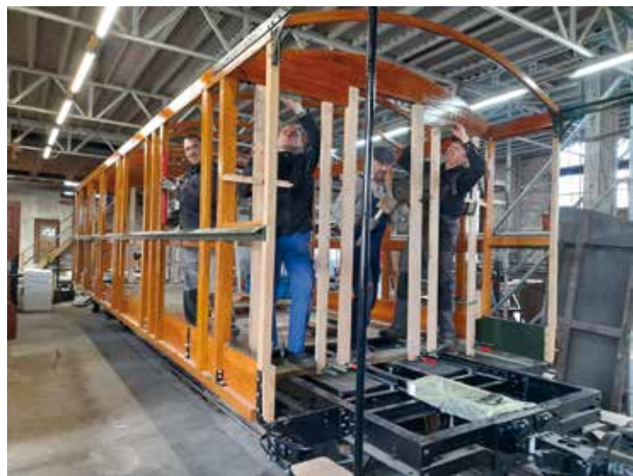
Mitglieder des Vereins Öchsle Schmalspurbahn passen im denkmalgeschützten Loksuppen in Ochsenhausen die Stirnwände des „Panoramawagens“ Stuttgart 132 an, 9. April 2022 (Foto: Bernhard Günzl)
