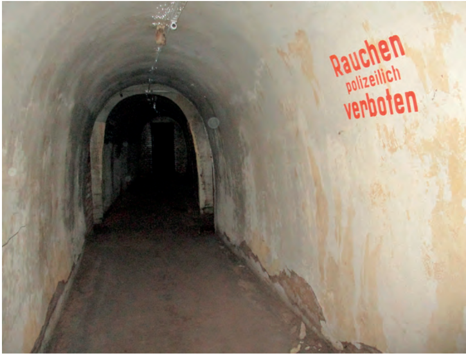
Mehr als 80 Stufen führen in den 1943 angelegten Bunker, der sich 16 Meter unter der Villa Reitzenstein befindet. Mehrere Gasschleusen sicherten den Zugang zum Stollen an drei verschiedenen Stellen. Im Bild die Schleuse in Richtung Richard-Wagner-Straße.
