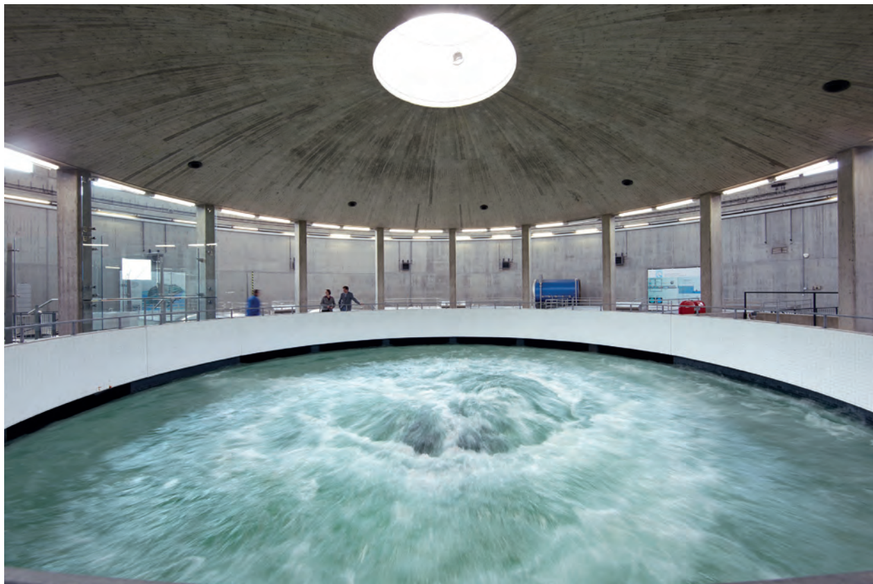
Trinkwasserfassung der Bodensee-Wasserversorgung auf dem Sipplinger Berg
