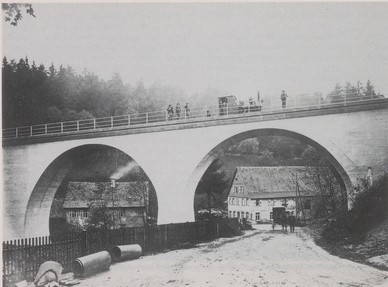
Alte und neue Zeit begegnen sich: oben die Eisenbahn, unten die Postkutsche. Aufnahme aus der Zeit des Bahnbaus. Heute wartet der Viadukt beim Bahnhof Laufenmühle auf seine Sanierung.
