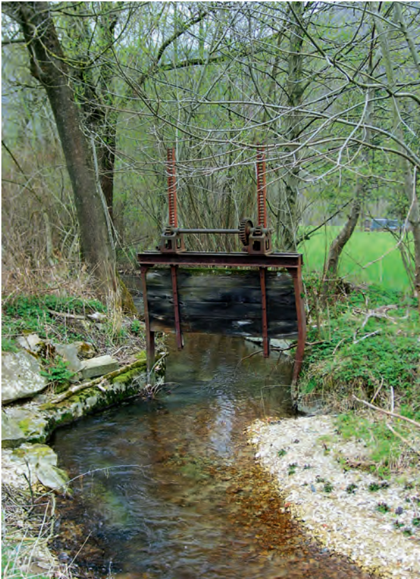
Schutz zur Verteilung des Wasserwassers im Lenninger Tal.
