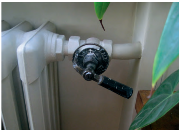
Das 90 Jahre alte Heizsystem mit Koks und Warmwasser ist noch immer in Betrieb, auch die Drehgriffe mit der Aufschrift «kalt» und «warm».
