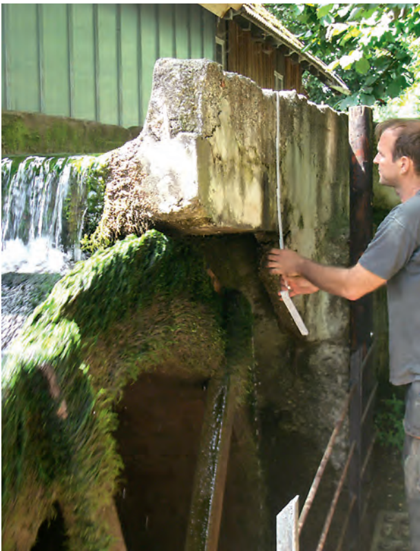
Martin Ludwig vermisst die schadhaften Betonteile am Zulauf zum restaurierten Wasserrad der Sägemühle am Sandhof in Langenenslingen.
