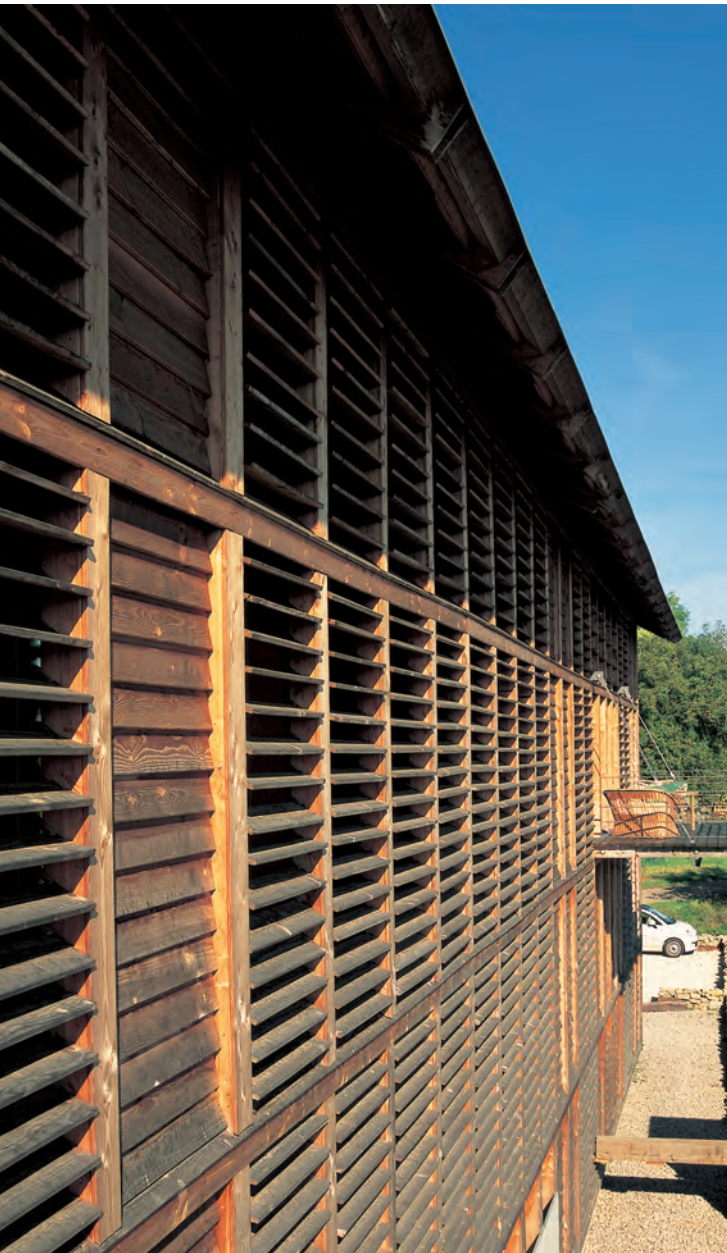
Die charakteristische Außenhaut des Tabakschuppens mit ihren verstellbaren Lamellen nach der Erneuerung.
