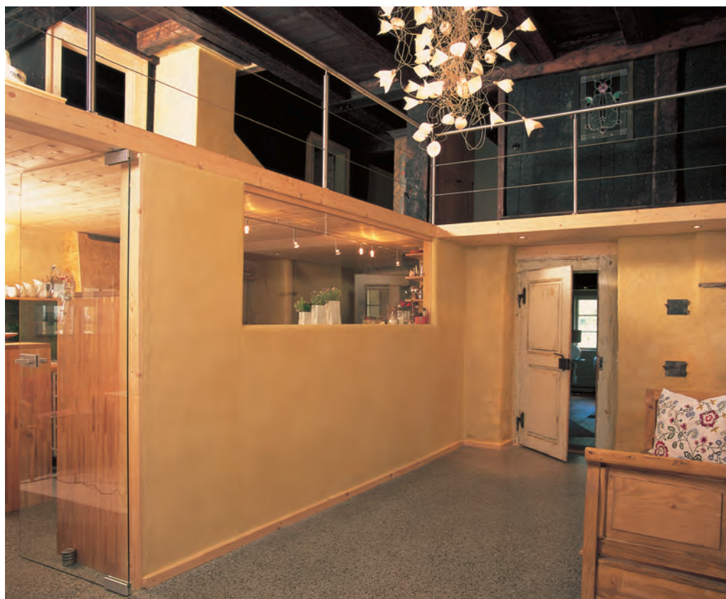
Alt und Neu im Franz-Seppe-Hof: der Einbau der modernen Küche in die wieder freigelegte, durch beide Stockwerke reichende Rauchküche von 60 qm.
