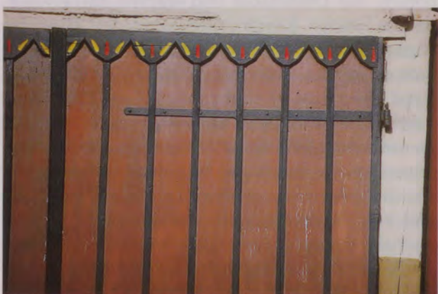
Der «Künstler» empfand die Deckleisten als Stiele, denen er Blüten aufsetzte. Um das Florale des Ornaments zu betonen, malte er die durch Vertiefung angedeuteten Blütenblätter farbig aus. Rechts ist noch die Rohrschelle zur Aufnahme des oberen Zapfens vom einstigen Drehbalken zu sehen.
