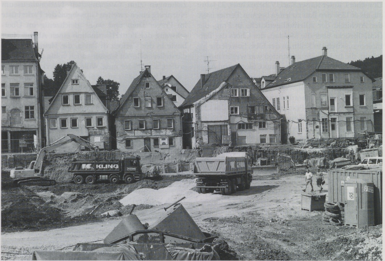
Rückseite der Häuser Vordere Schmiedgasse 20–28; Nr. 26, das zweite Haus von rechts, im Kern von 1337, ist inzwischen abgebrochen
