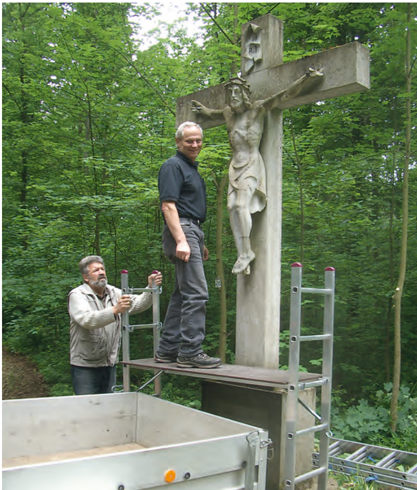
Die Schäden am Korpus dieses Steinkreuzes in Assamstadt konnten durch sorgfältige Reparaturen und eine Umgestaltung beseitigt werden.
