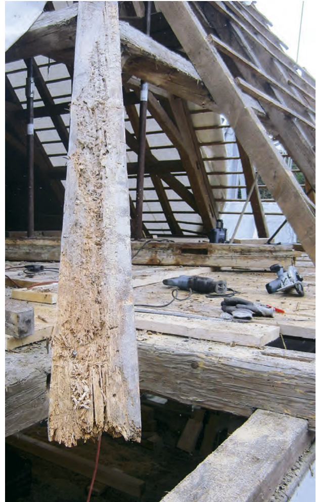
Auch hier waren gravierende Schäden zu beseitigen. Eine Aufnahme während der Sanierung.
