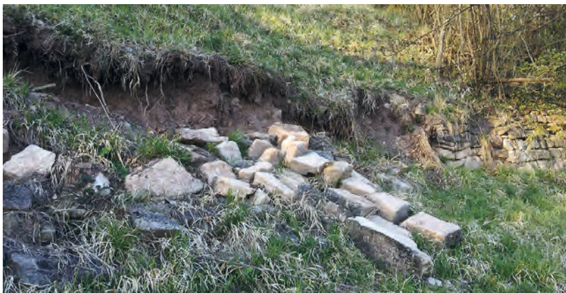
Der Verfall dieser Mauer beeinträchtigt nicht nur das Bild der Kulturlandschaft, sondern gefährdet auch die Stabilität eines oberhalb führenden Weges.
