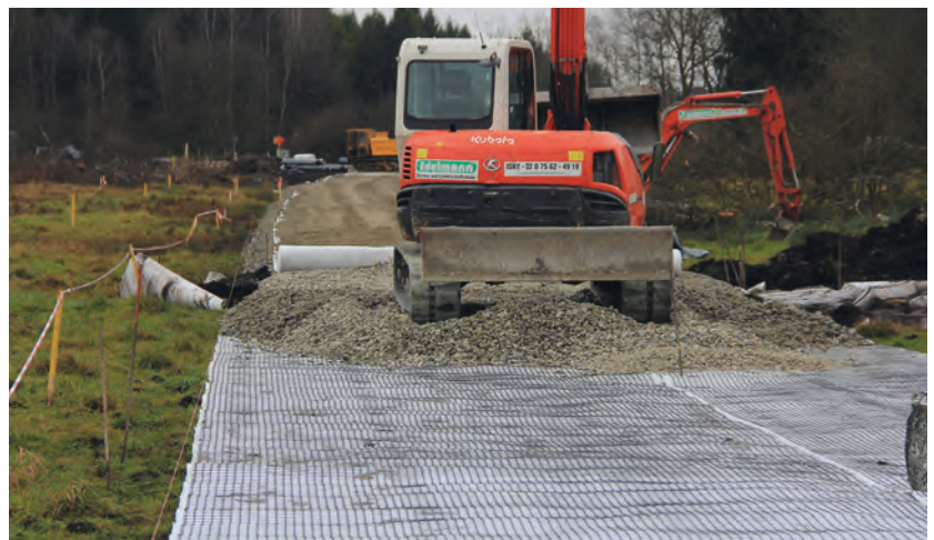
Bau eines sogenannten «schwimmenden Weges» im Rahmen des Großprojekts. Das Geotextil verhindert das Einsinken des Weges in die darunter liegenden Torfschichten.
