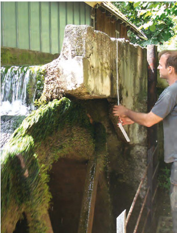
Martin Ludwig vermisst die schadhaften Betonteile am Zulauf zum restaurierten Wasserrad der Sägemühle am Sandhof in Langenenslingen.
