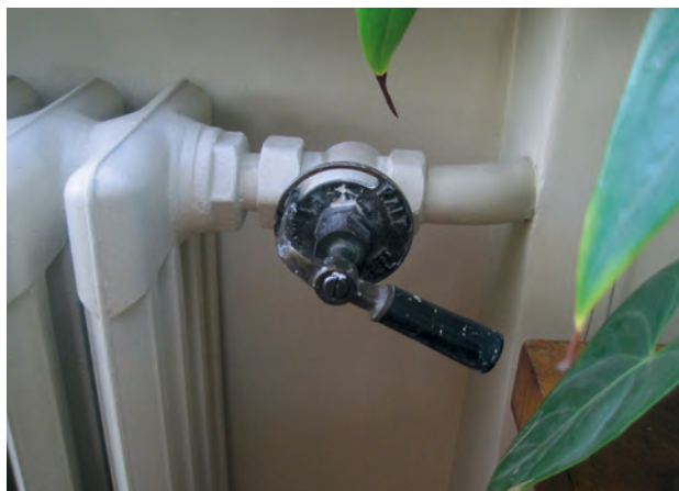
Das 90 Jahre alte Heizsystem mit Koks und Warmwasser ist noch immer in Betrieb, auch die Drehgriffe mit der Aufschrift «kalt» und «warm».
