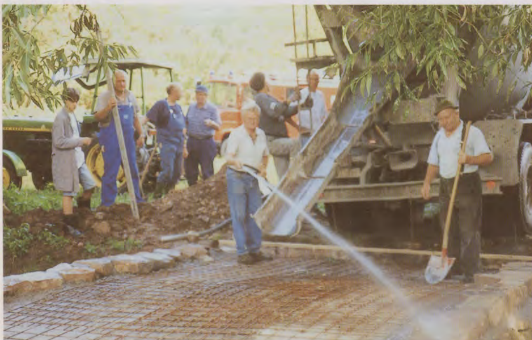
Zahlreiche Helfer fanden sich ein, um die steinerne Bogenbrücke bei Oberschwandorf grundlegend zu sanieren.
