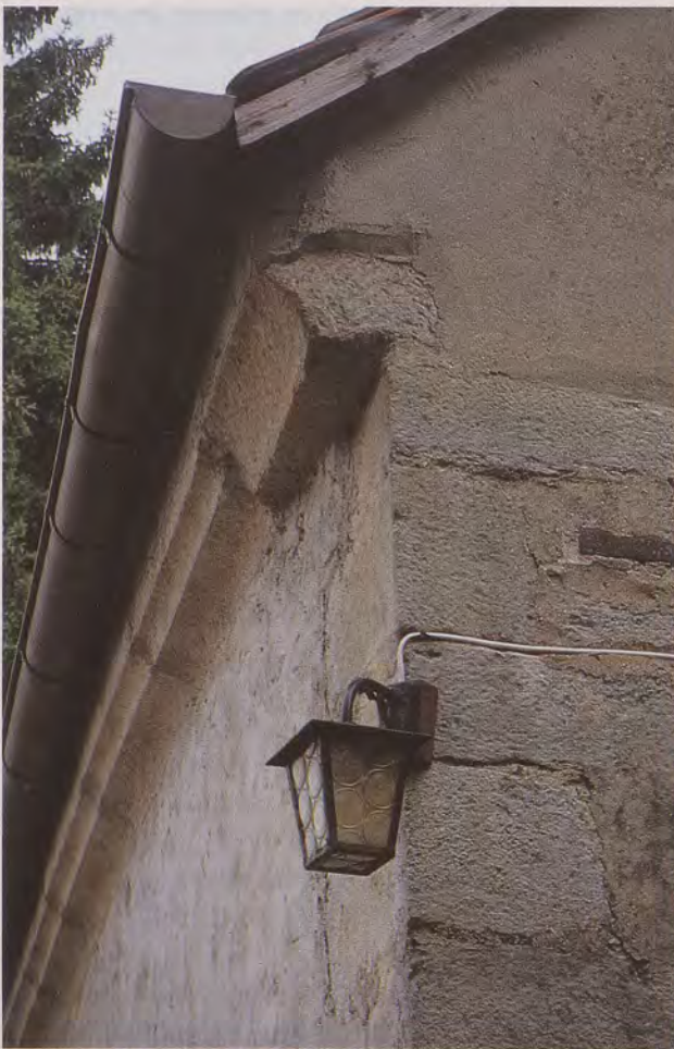
Dachgesimssteine an der Nordwestecke der Sakristei heute. Man sieht deutlich den Unterschied zwischen den gotischen, mehrfach gefalteten Mauerabschlußsteinen links und dem schlichten romanischen Hohlprofil rechts, das typisch für die romanischen Bauteile der Nikomedeskirche ist. Der romanische Mauerabschlußstein beweist, daß hier heute noch die Ostwand des Chors der «alten Hofkapelle» steht. Sie ist der Pfalzgrafenburg zuzuordnen, die 1165 von Welf VII. zerstört wurde.
