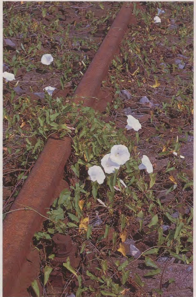
Sommer 1995: Die Geleise der Schönbuschbahn sind bereits überwachsen. Bei aller Blütenschönheit zum Glück ein Bild, das jetzt Vergangenheit ist.
