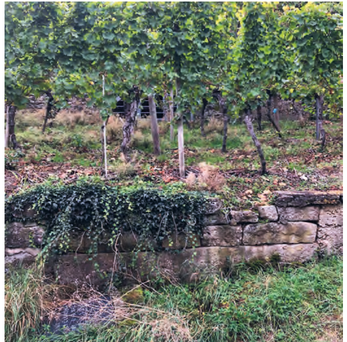
Vor Beginn der Restaurierungsarbeiten war vom ehemaligen Eiskeller im Weinberg nahezu nichts mehr zu sehen.
