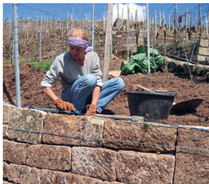
Die exakte Bearbeitung und Einpassung der Steine sind eine entscheidende Grundlage für eine möglichst lange Stabilität der Mauer.
