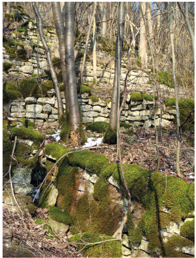
Weinbergmauerreste im Wald bei Rielingshausen, Gewann Steinberg: Wurzeln lockern das Mauergefüge und bringen es zum Einsturz.
