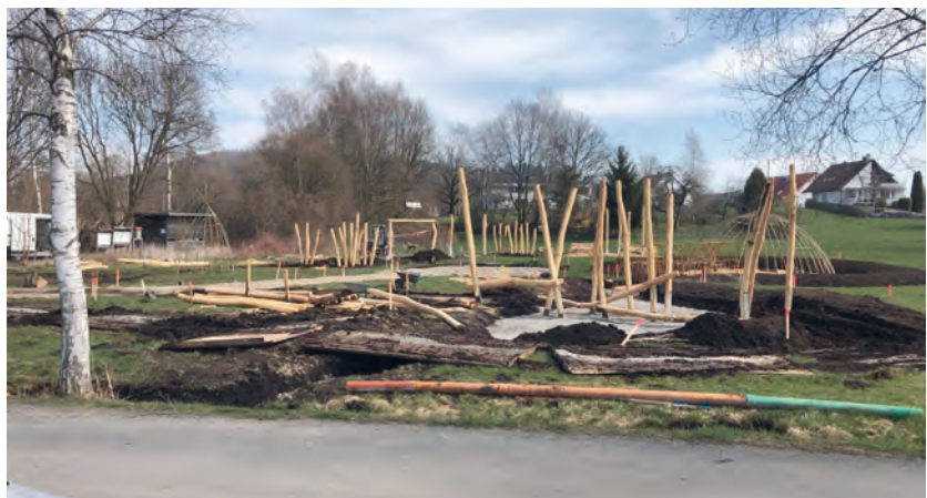
Die Baustelle des Naturparcours neben dem Naturschutzzentrum. Hier entsteht ein Naturerlebnisgelände für Kinder mit vielen Bewegungsmöglichkeiten.
