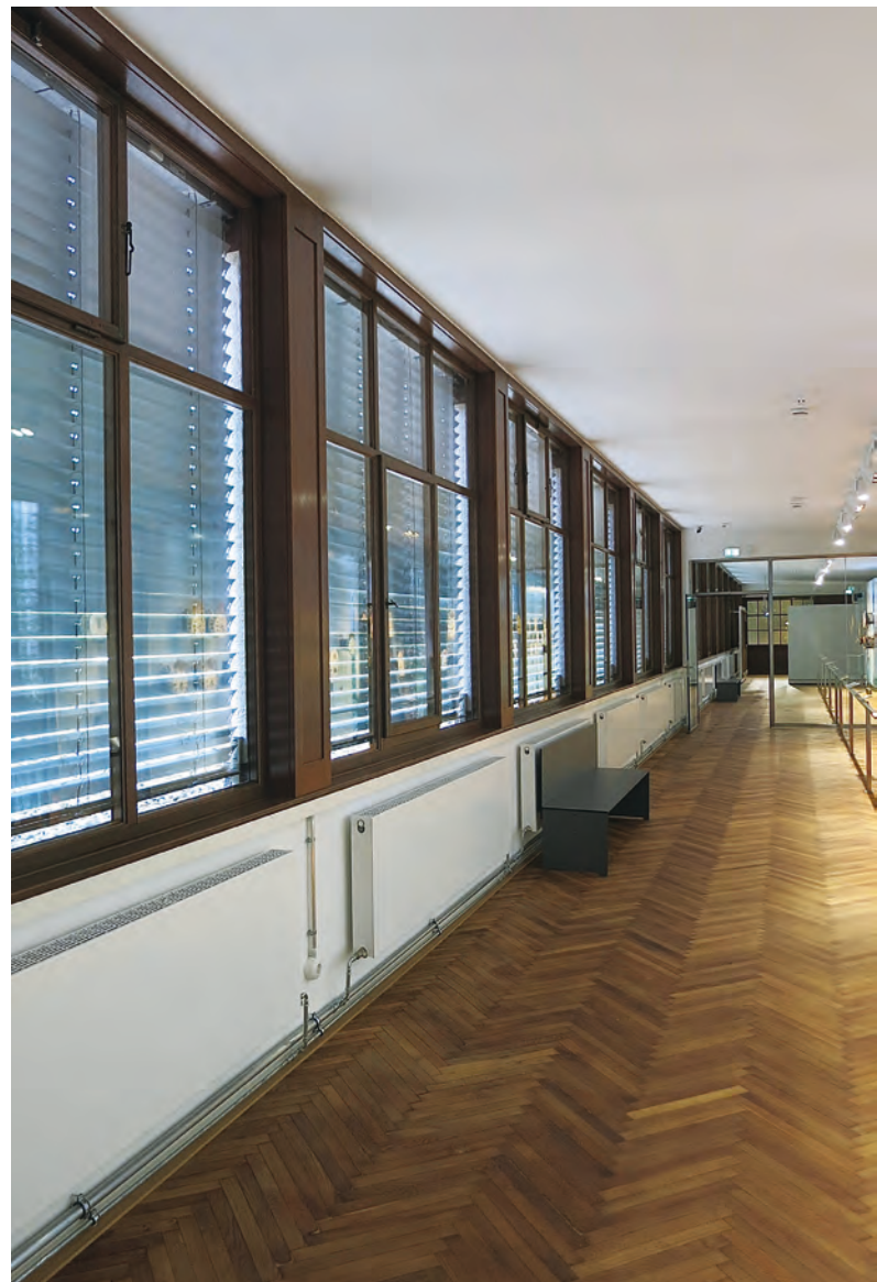
Die originalen Panzerfensterbänder mit fester doppelter Verglasung in den Arbeitsebenen wurden aufwändig saniert.
