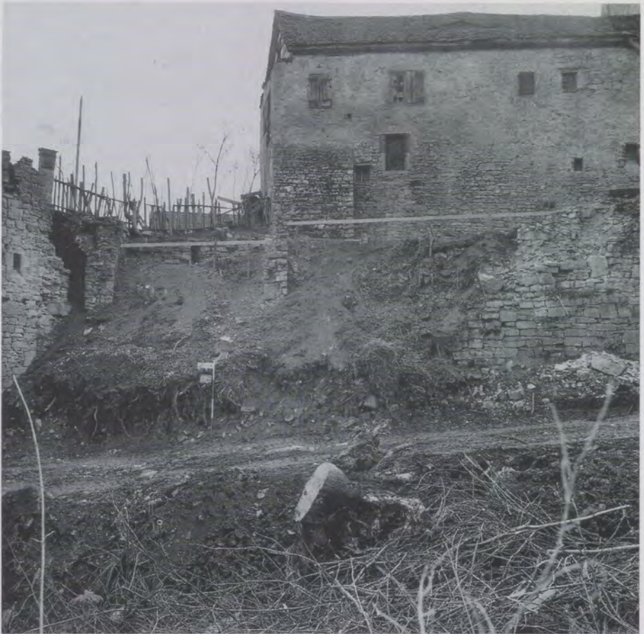
Abb. 3 Burg Amlishagen, eingestürzte Ostmauer zu Beginn der Sanierungsmaßnahme 1984 (Foto: Landesdenkmalamt Baden-Württemberg)
