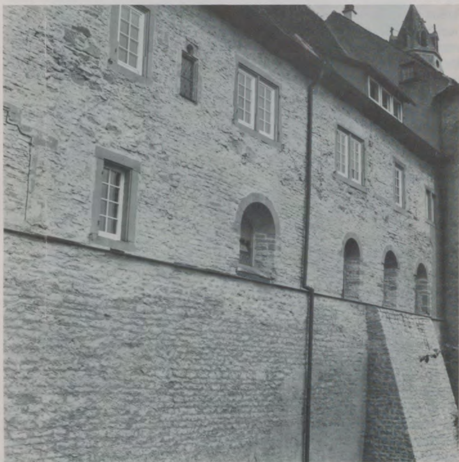
Abb. 3 Südfassade im Bereich des Kapitelsaales mit unterschiedlicher Mauerstruktur.
