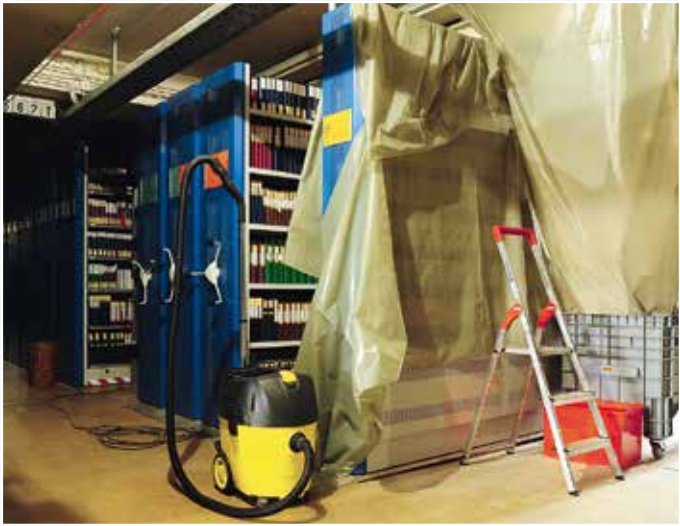
Abb. 2: Wassereinbruch am 21./22.11.2016, 1. UG, Abschnitt 3
