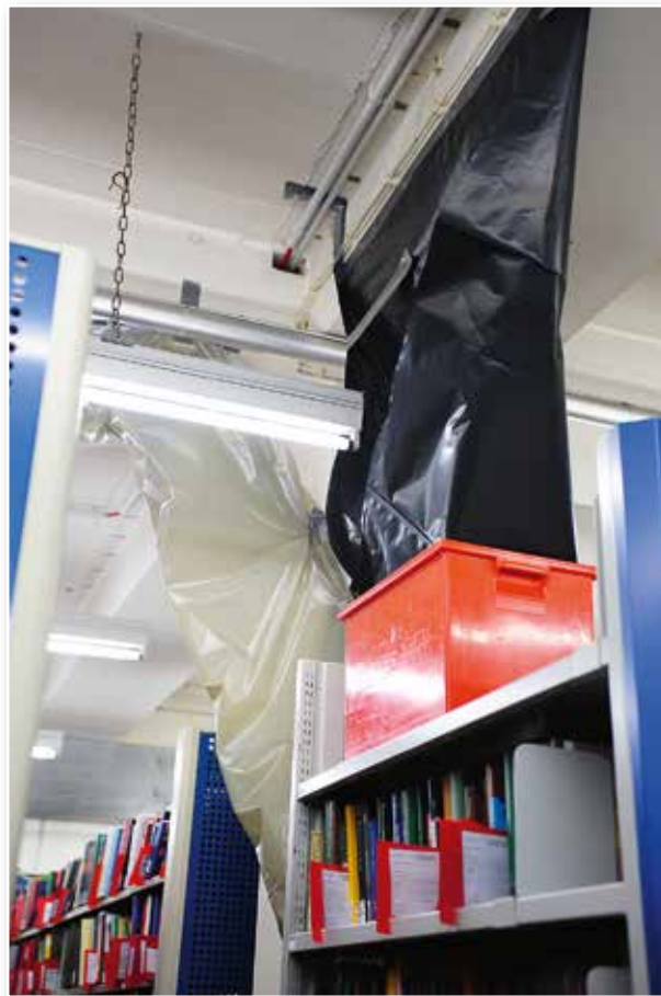
Abb. 1: Wassereintrich am 7./8.11.2016, 1. UG, Abschnitt 7
