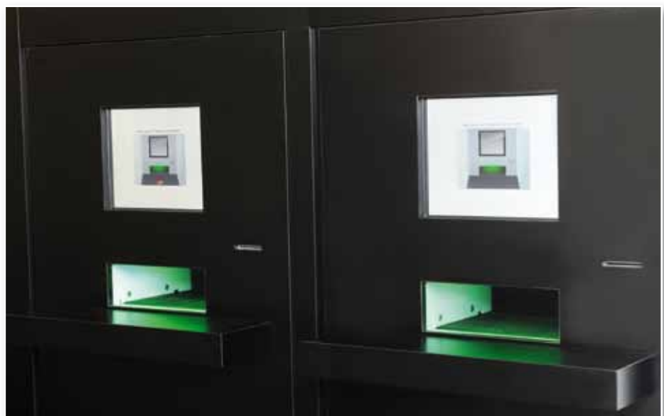
Rückgabe und Sortieranlage Stadtbibliothek Wiesbaden
